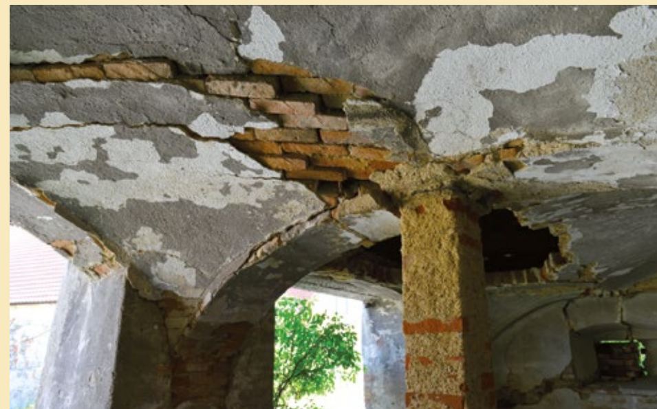
Interiér stájí – detail poškozené klenby, 2022.
