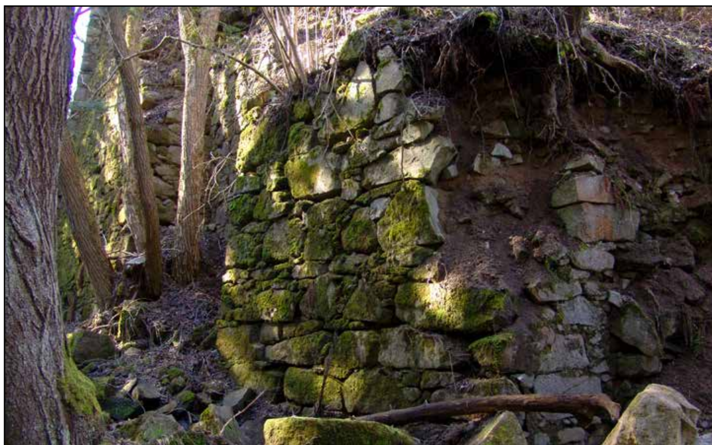
Poškození šikmého křídla, 2007.
