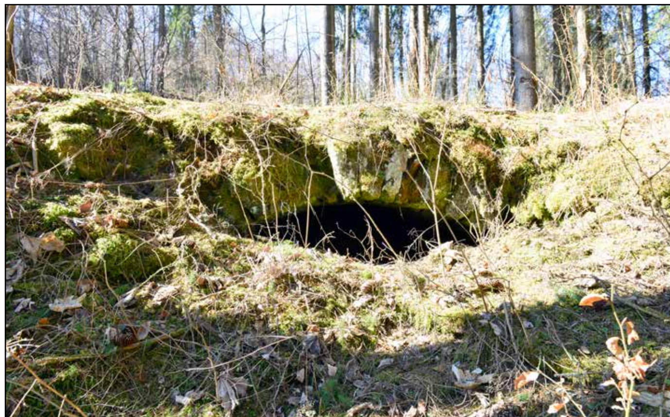
Téměř zasypaný propustek v náspu, 2022.
