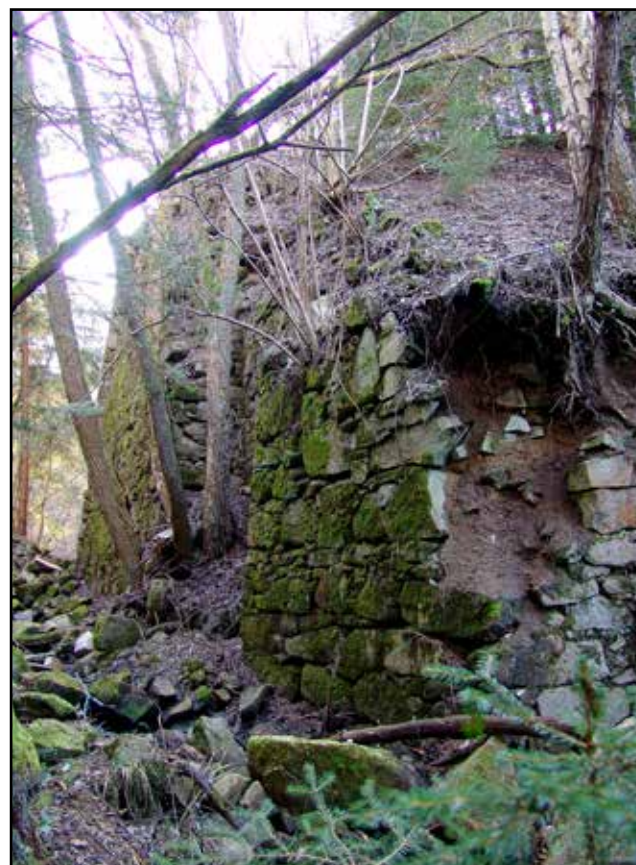
Pohled na poškozené východní křídlo pilíře, 2007.
