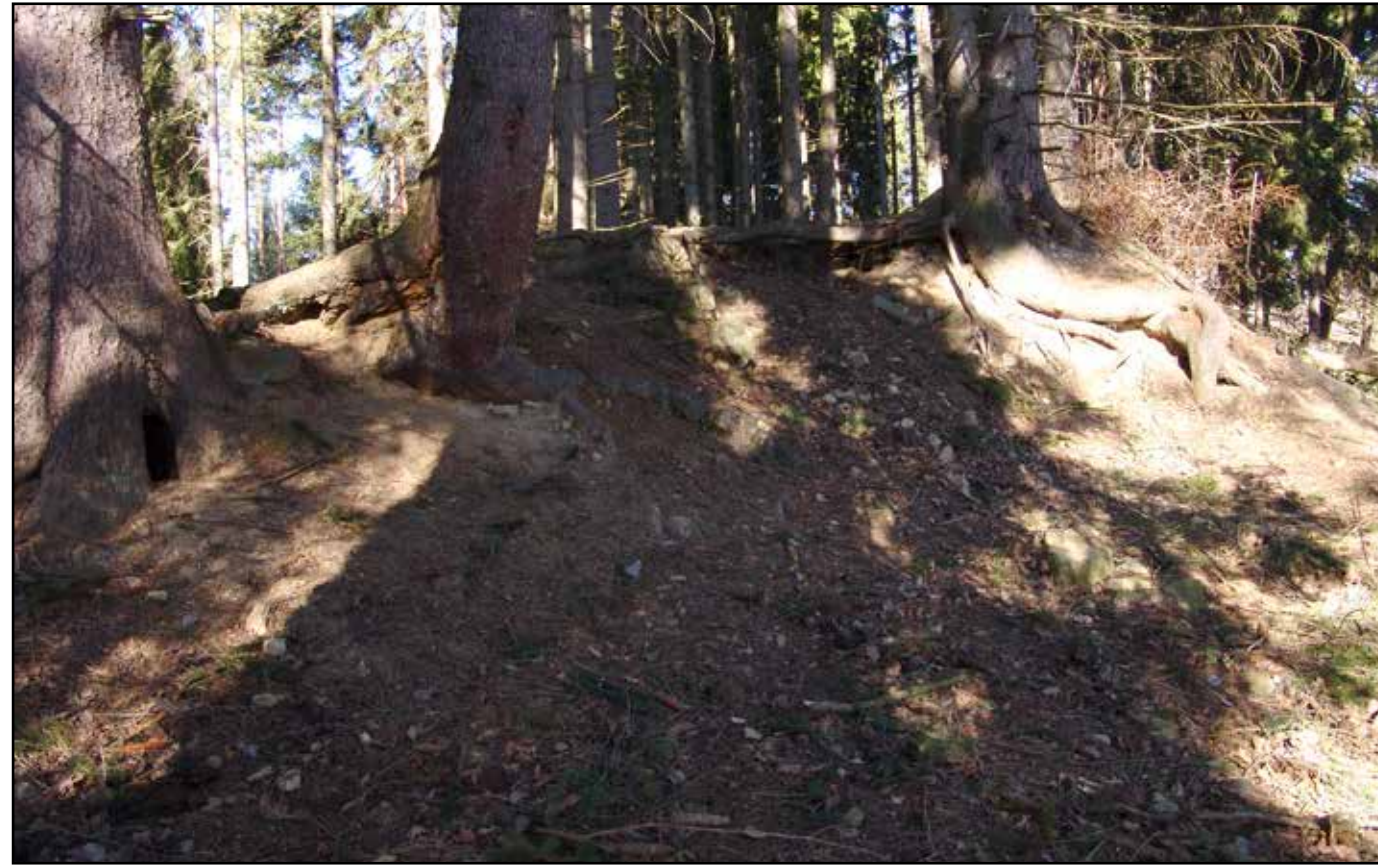
Poškozený jižní konec náspu, 2007.
