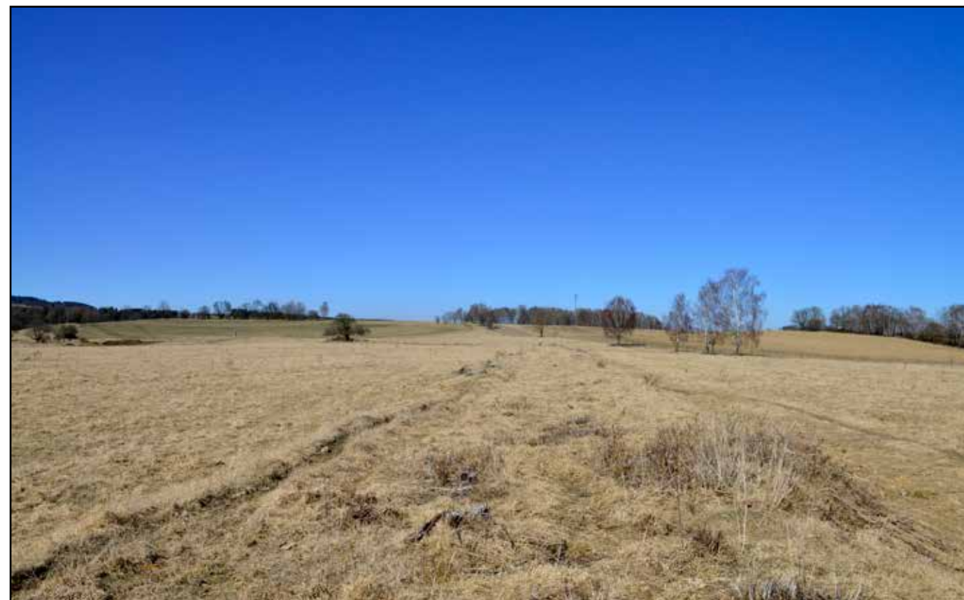
Pohled po koruně náspu směrem na sever, větší část náspu není evidována, 2022.
