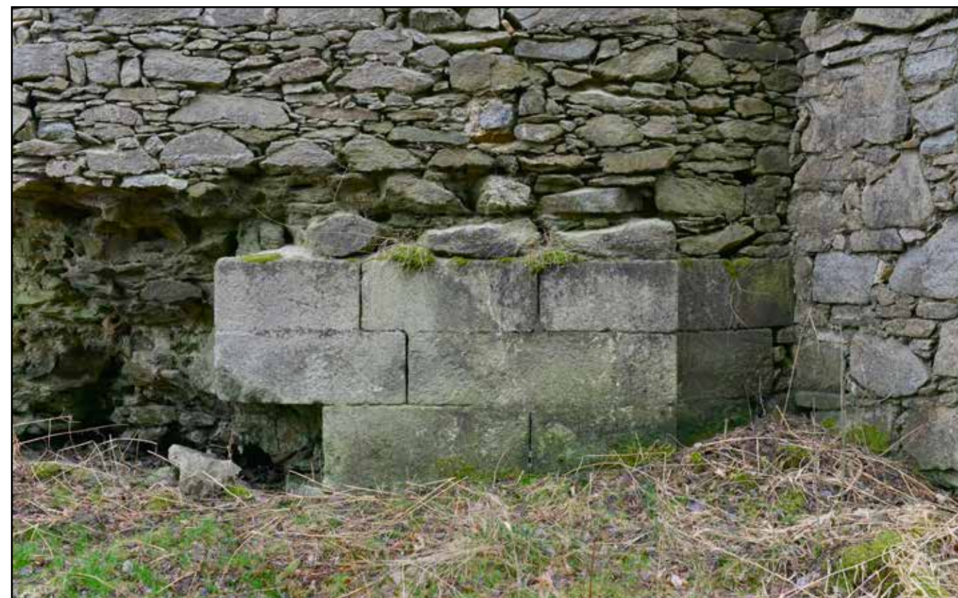
Poškozená pata východního pilíře, 2022.
