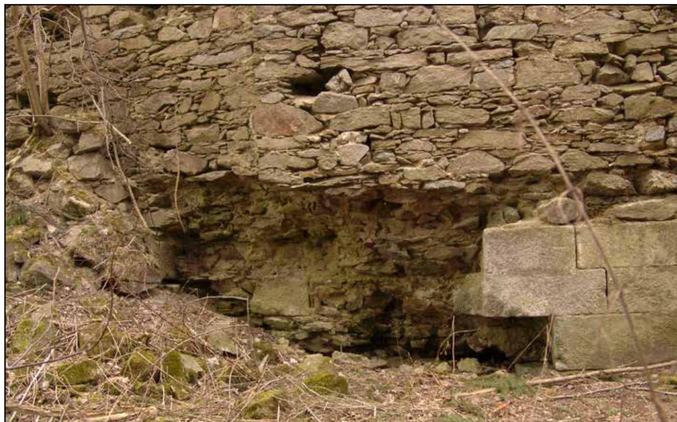
Detail poškozené paty východního pilíře, 2007.
