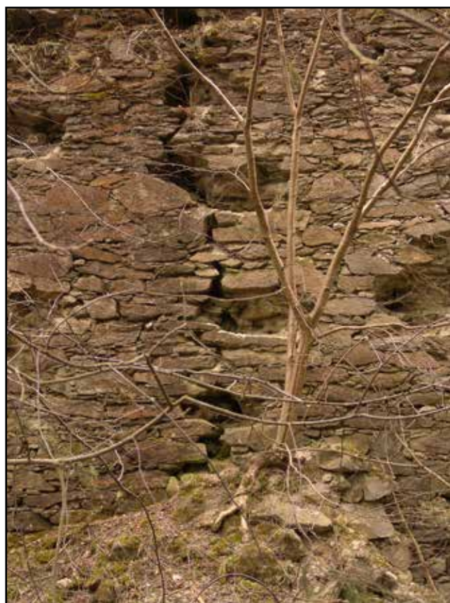
Poškozené zdivo pilíře v místě, kde byla přizděna opěrná zeď, 2007.
