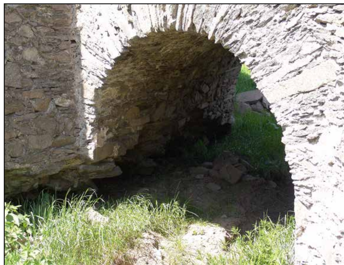
Detail poškozené jihozápadní paty a křídla můstku, 2007.
