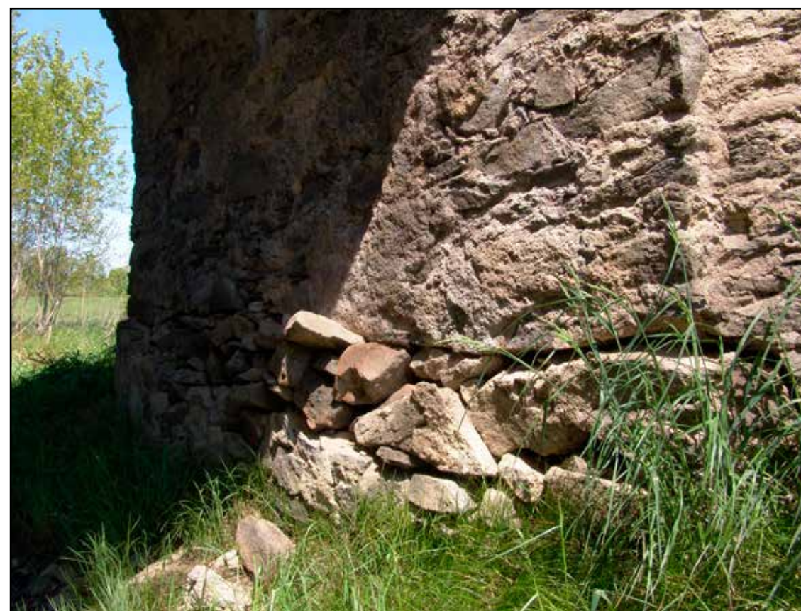
Detail poškozené východní paty mostu, 2007.
